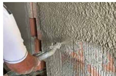
Application d'un FL-P Enduit à la chaux historique avec la machine à crépir
