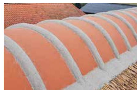
Finition du faite avec du mortier de couverture FL-D sur un toit recouvert de chaume
