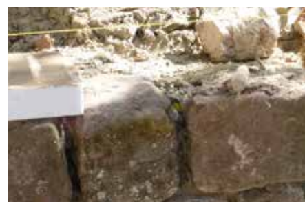
Réalisation d'un couronnement de mur avec FL-M Mortier de pierre de taille historique
