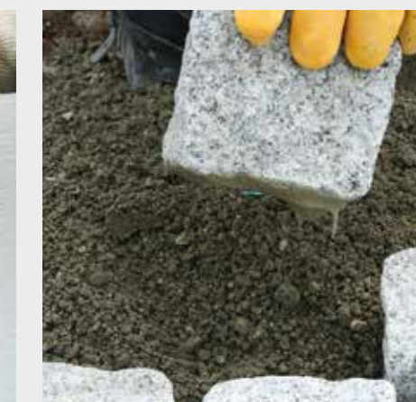
Placer et marteler l'élément de revêtement dans le mortier de pose frais (par exemple, tubag TPM-D4).
